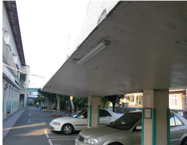
更換省電 LED 燈管－停車場
