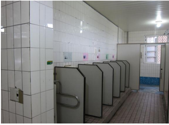
廁所修繕前的狀況
