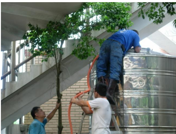
水塔清洗保水質
